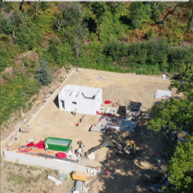
ESTAÇÃO DE TRATAMENTO DE ÁGUA DE ALQUEVE (FOLQUES)
