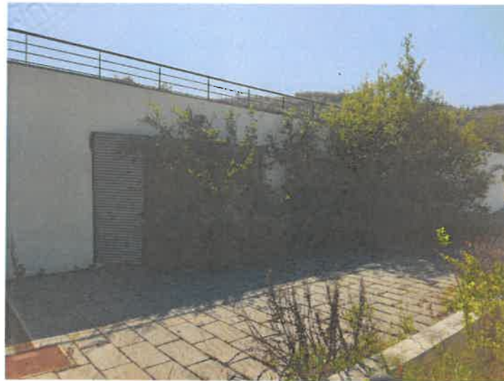
-----Foto n.º 2: Sinais de vandalismo/proliferação de vegetação. -----
