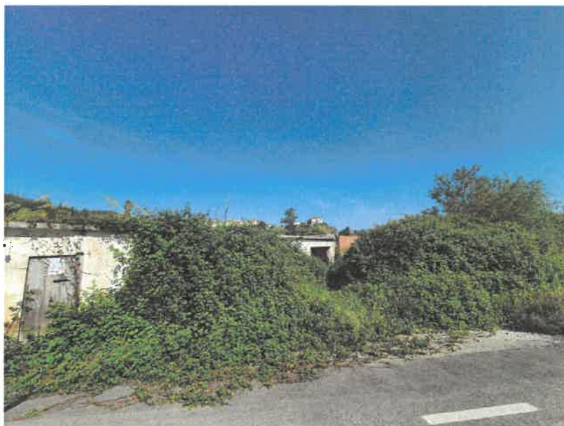
----- Foto n.º6: Falta de gestão de combustível.-----
