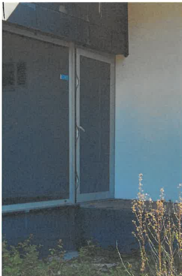
----- Foto n.º4: Sinais de vandalismo. -----
