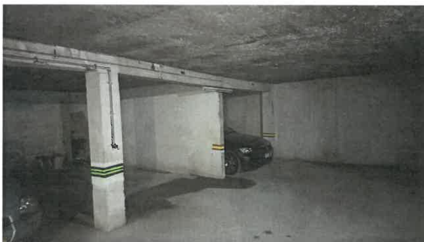
-----Foto n.º2: Tramo n.º6, flexão acentuada com a respetiva fendilhação (2/4/2019). -----
