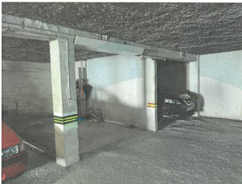
-----Foto n.º3: Tramo n.º6, flexão acentuada com a respetiva fendilhação (22/9/2020). -----
