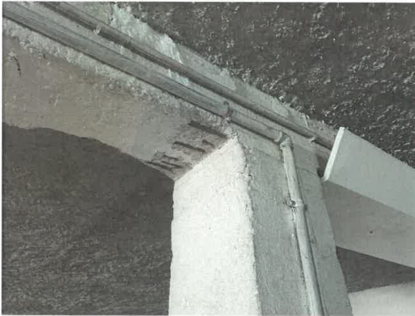
-----Foto n.º5: Flexão acentuada/armaduras expostas (22/9/2022). -----
