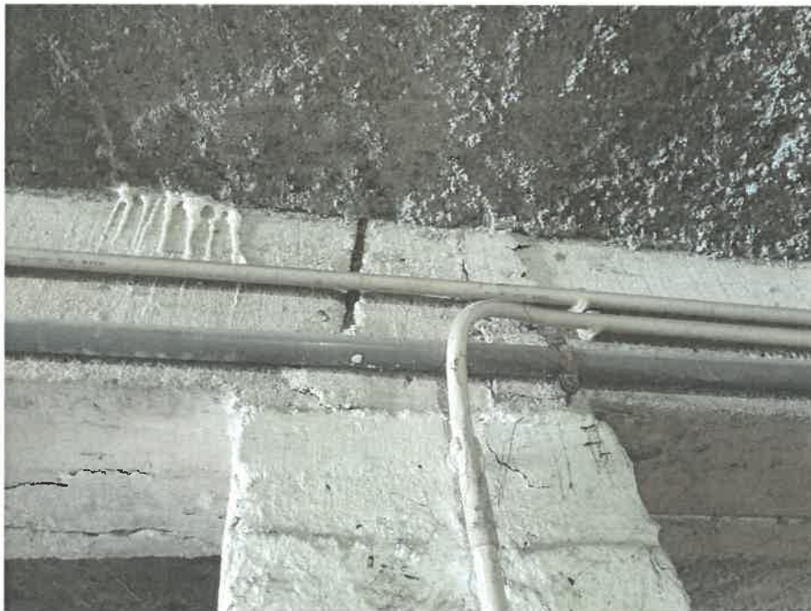
-----Foto n.º10: Recobrimento insuficiente nos elementos estruturais. -----
