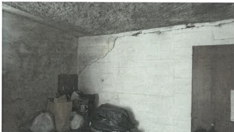
-----Foto n.º8: Fendilhação em outros elementos estruturais (2/4/2019). -----
