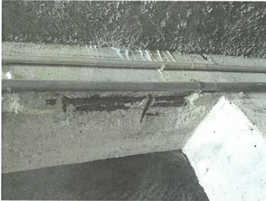
-----Foto n.º7: Flexão acentuada/armaduras expostas (22/9/2020). -----
