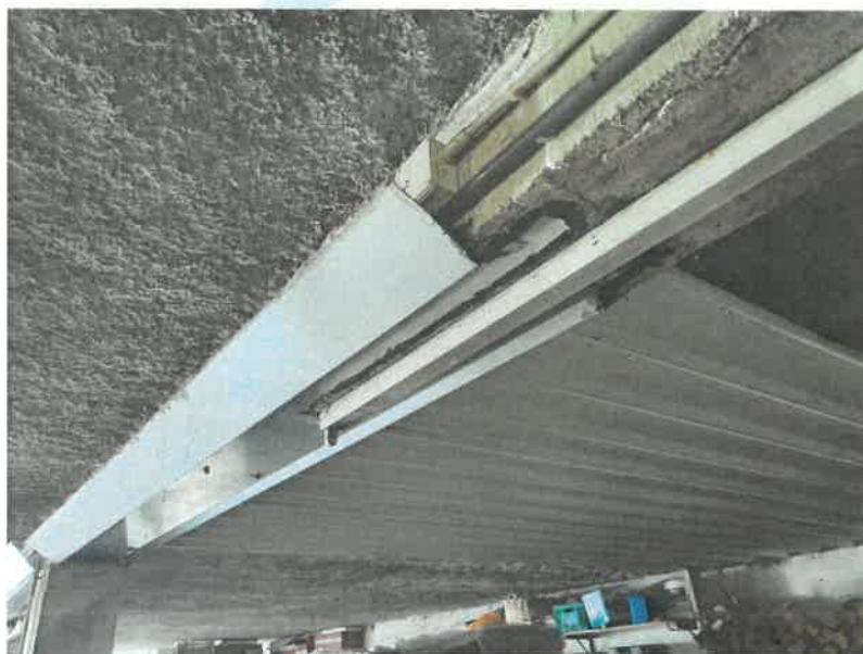
-----Foto n.º1: Pontos com afluência de humidade/chapas instaladas. -----
