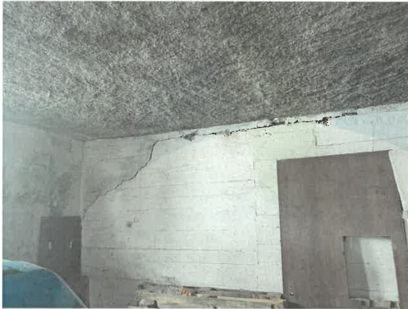
-----Foto n.º9: Fendilhação em outros elementos estruturais (22/9/2022). -----
